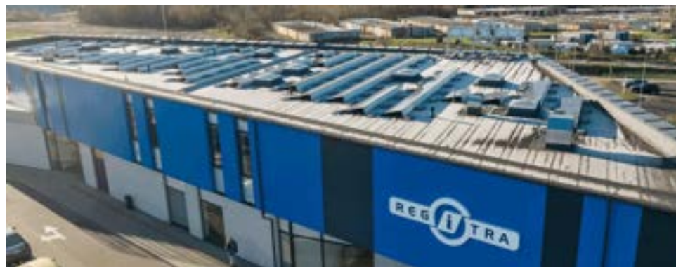
6 pav. Saulės elektrinė AB Regitra Klaipėdos padalinyje
